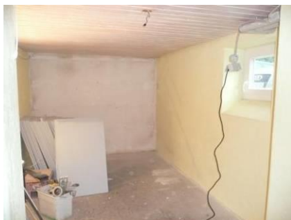
Schimmelbehandlung mit AS SporenStopp im Kellerraum
