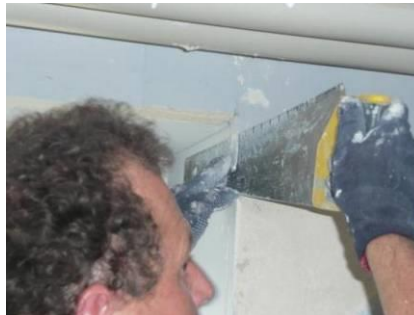
Plattenüberstände in Laibungen können einfach vor Ort mit dem Fuchs- schwanz abgesägt werden.
